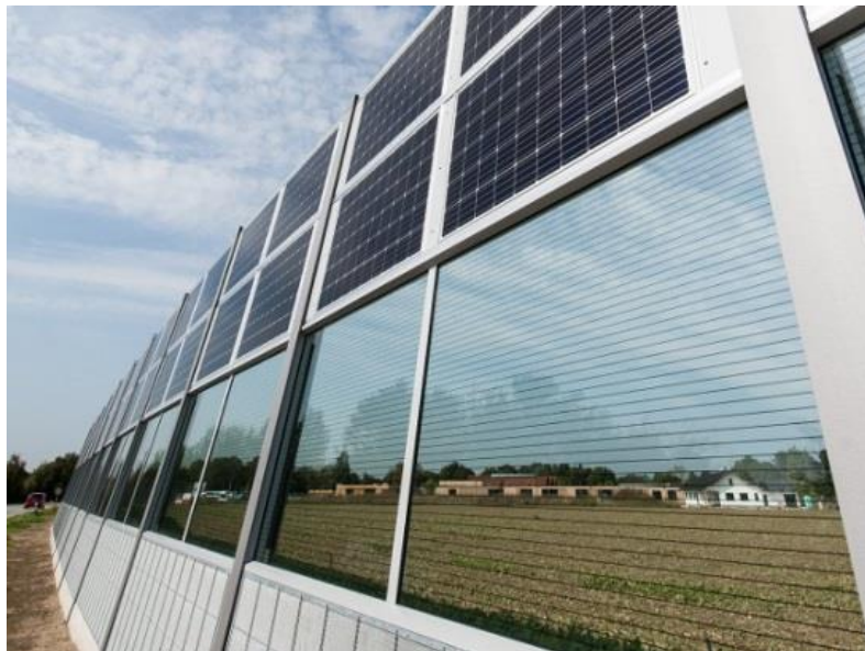
Abb. 48 Lärmschutzwand mit integrierter Photovoltaik im oberbayrischen Neuötting. [32]
