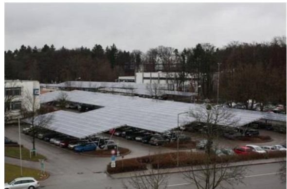
Abb. 21 Konventionelle Solare Überdachung in Burghausen [14]. Die Stadt setzt mit der 258 kWp Anlage über dem Parkplatz den ersten Grundstein hin zur „Solarstadt“ und kalkuliert dabei mit einer Rendite zwischen 8 und 9 %.
