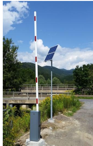
Abb. 51 Solarschranke ohne Netzanbindung, die ausfallsicher über das ganze Jahr betrieben werden kann. [13]
